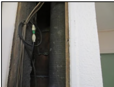
Photo N° 645 AMIANTE CIMENT -- GAINE TECHNIQUE eau usé - RDC Gaines & coffres verticaux Chute E.U.(Fibres-ciment)
